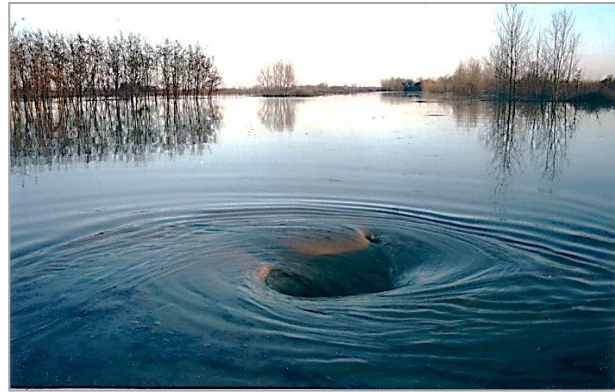
8. kép. Vízömlés a 41-es műút alatti áteresznél (Fotó: FETIVIZIG) Picture 8. Water sink at the culvert under highway 41 (Photo: FETIVIZIG)
