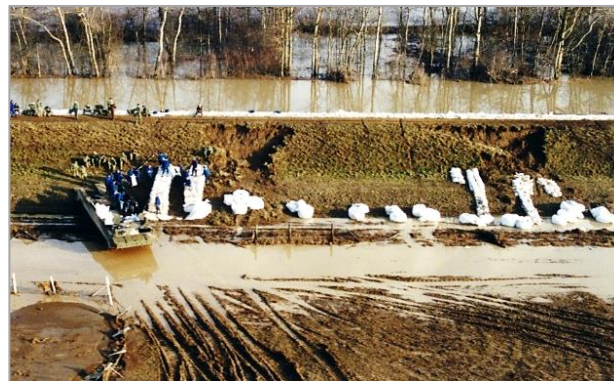
5. kép Suvadások, melyekből nem lett gátszakadás: a suvadások különleges alakja két nappal a gátszakadás után. (Megjegyzés: A mentett oldali koronaélből függőlegesen lesvadt talaj, mint egy sárfolyás, a töltés lábánál legyező alakban szétterült. Ld. még 1. és 2. képet.)
