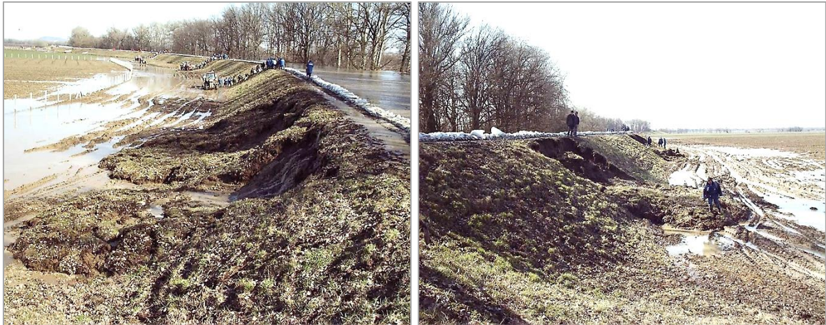
1. és 2. kép. A mentett oldali koronaélből lesuvadt talaj a mentett oldali töltéslábnál legyező alakban szétterült Photo 1 and 2. The slide soil from the protected side of crown has spread in a fan shape at the protected side ground surface
