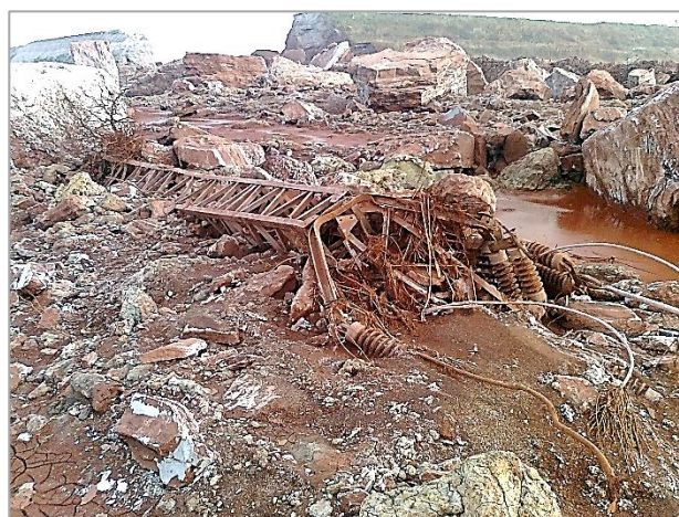
3. kép. A gátszakadás helyszíne az eltört villanyvezeték oszloppal Photo 3. The location of the dam failure with the broken power line pole
