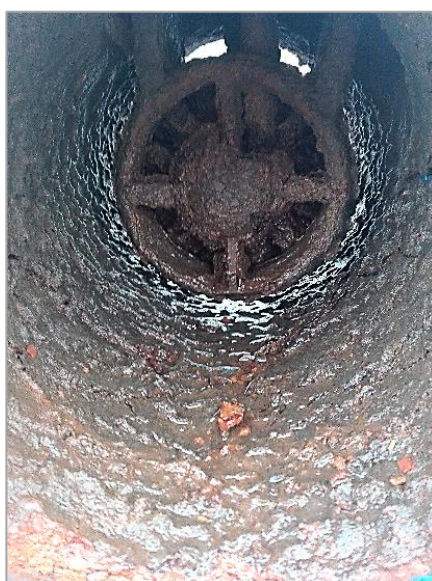
10. kép. Parti szűrésű vízműkútból kiépített szerelvény vas- és mangán csapadékkal borított belső felülete (Forrás: BÁCSVÍZ Zrt.) Photo 10. Inner surface of a removed kit from a bank-filtered water well coated with iron and manganese precipitation (Source: BÁCSVÍZ Zrt.)
