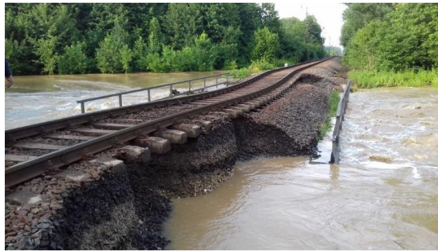
5. fénykép. Az alámosott vasúti híd Ötvöskőnyi és Beleg között Forrás: Irodalomjegyzékben
