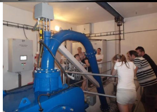
A Pelton turbina 350 l/s - 85 kw - vízkezelőbe
