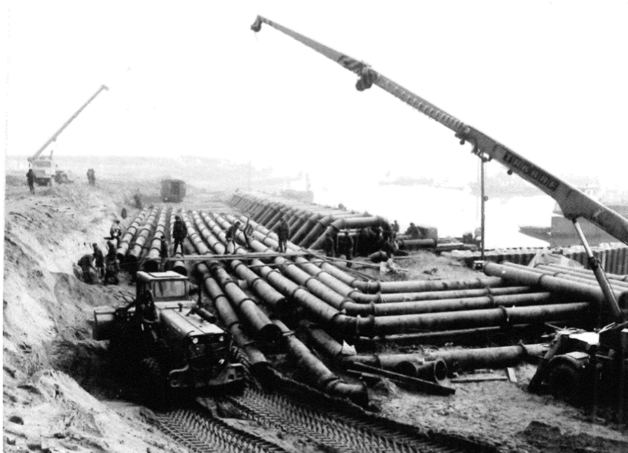
4. fénykép: 2000 méter összhosszúságú beépített csőrendszer.
