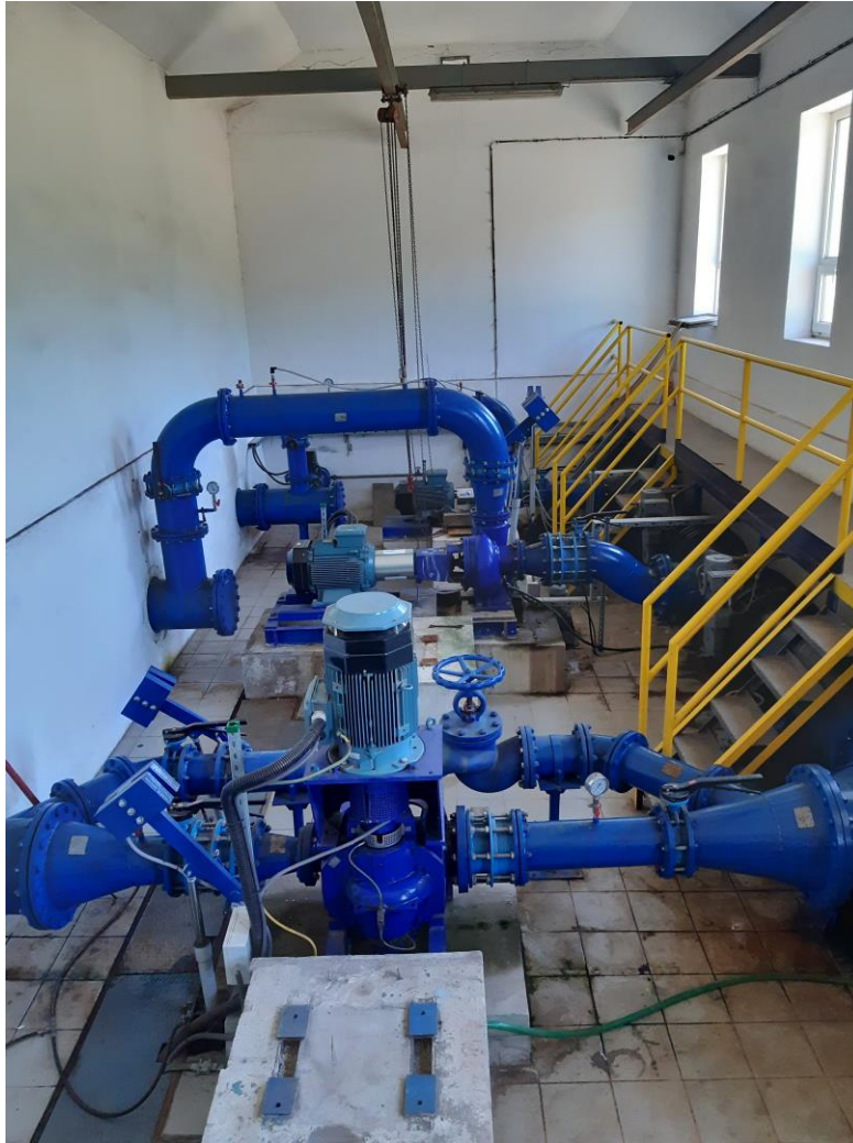
11. Ábra. Az MVE2 törpevízierőmű telep
