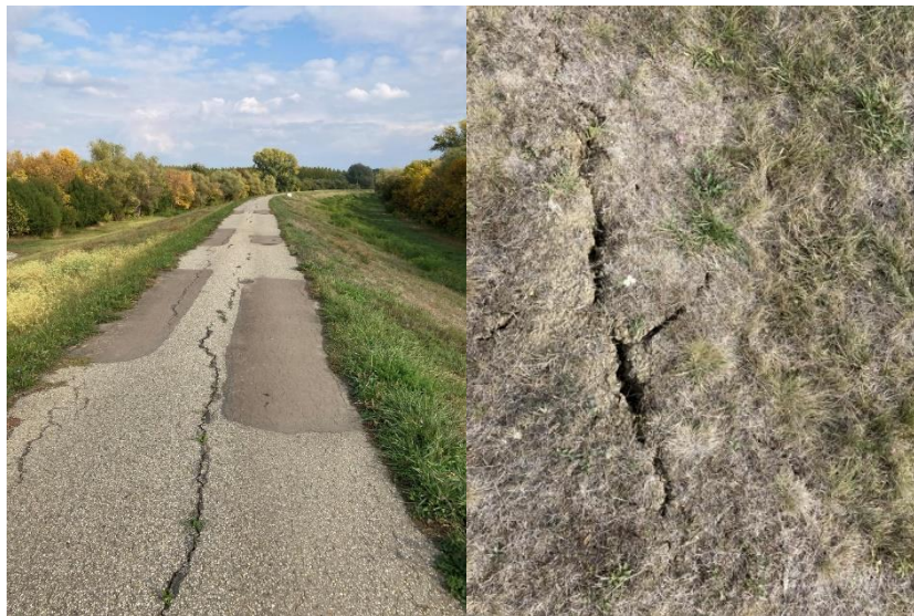
2. ábra Repedezett töltés korona burkolat és a vízdali részsűn megjelenő merőleges repedések
