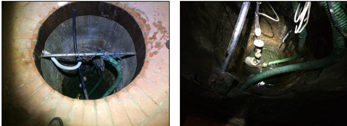
1. kép. A Mély kút leszívás előtt és után (A jobboldali képen látható, hogy a szivattyút teljesen bevonta a vízkő.)
