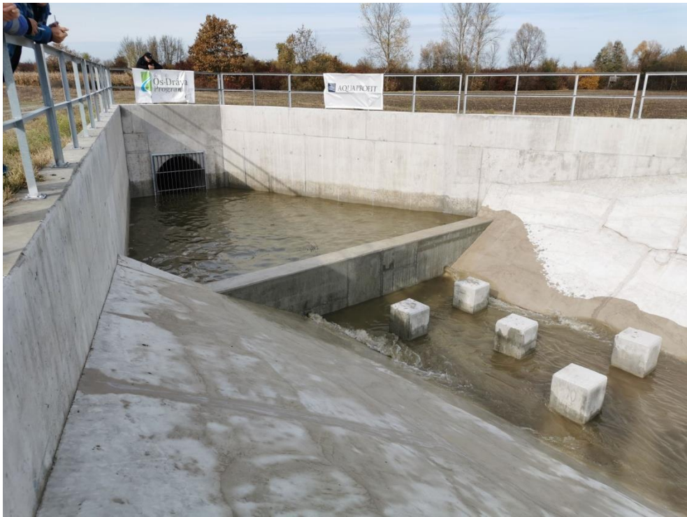
17. kép. Nyomóvezeték belépése a csillapító műtárgyba II.
