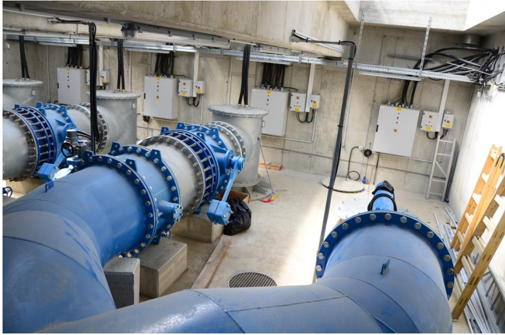
10. kép. Szivattyútér kész állapotban
