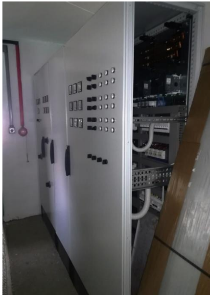
21. kép: A már elavult irányítástechnikai rendszer helyett korszerű PLC típusú vezérlési rendszer kiépítése történt meg, tejesen új kapcsolószekrények beépítésével.
