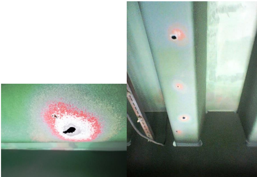
18. kép: 2019.06. 18.-án: Az ortotróp acéllemezen sweppelés közben észlelt hibák
