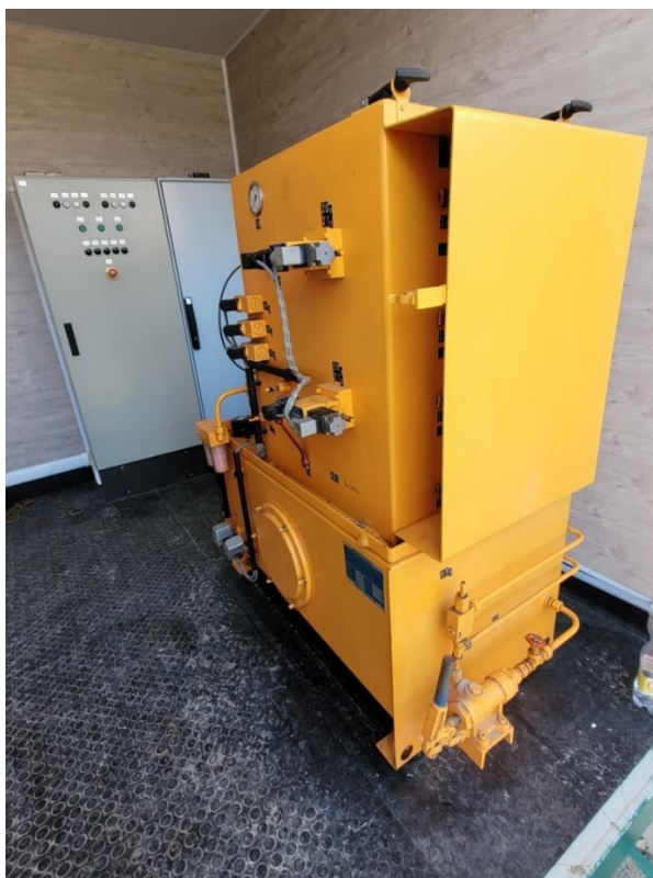
12. kép: A felújított Rajkai VI. számú vízkivételi zsilip irányító konténere, 2022 január 27-én
