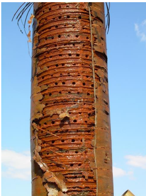
7. kép: Vas-oxid bevonat a kútból kiépített szűrőrakaton (BÁCSVÍZ Zrt., 2007)
