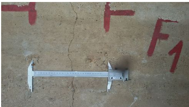
11.kép Repedés hézagának mérése tolómérővel
