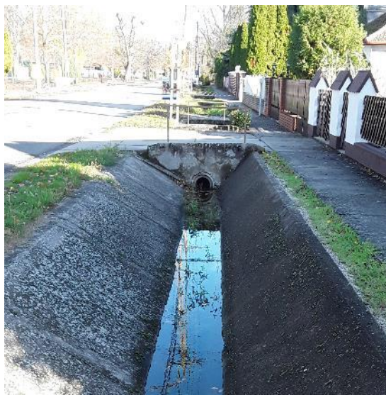
11. fénykép. Hatalmas kibetonozott árok, szűk átteresz
