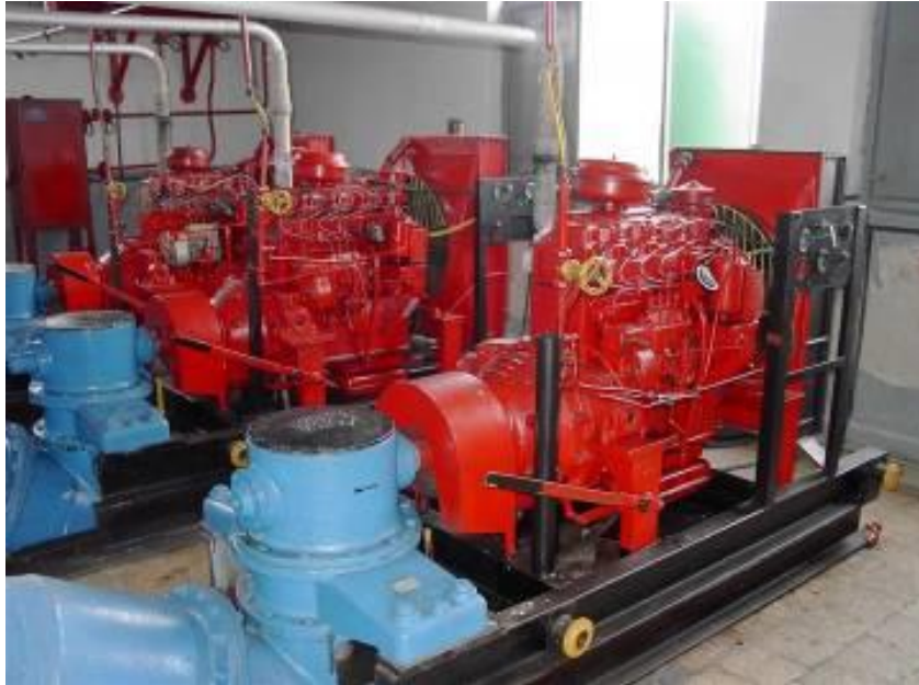
3.ábra: A meglévő Gástyási II. szivattyútelep gépei
