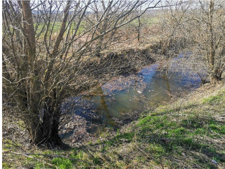
9. fotó: Góitói 1. csatorna 5+016 cskm átereszt felvív (2023.03.11.)
