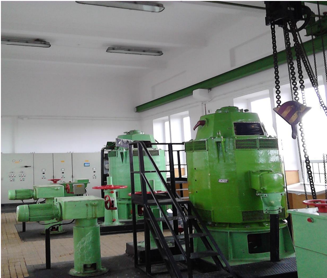
6. kép Borz II. szivattyútelep gépház
