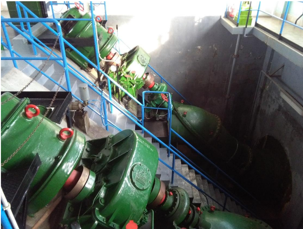
5. kép Hamvas szivattyútelep gépei
