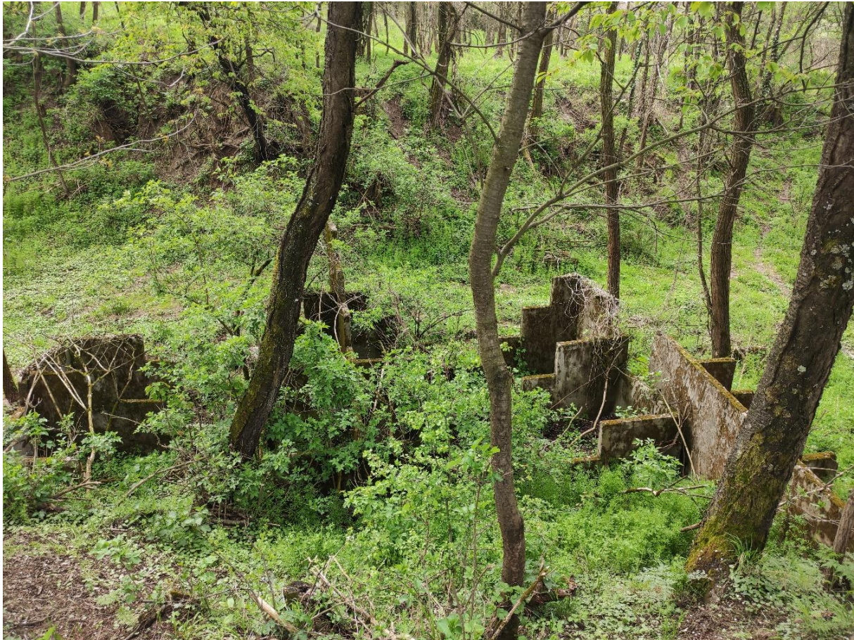
8. ábra. Tönkrement hordalékfogó gát
