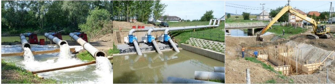
4. ábra. 2019. évi vízminőségi kárelhárítás keretében végzett szivattyús vízpótlás, a Bodrog folyó torkolatánál az I. számú szivattyúállás (1. kép), a Felsőberecki szivattyútelepnél kiépített II. szivattyúállás (2. kép) és a főcsatorna torkolatánál a mozgógereb építése (3. kép) (saját felvételek)
