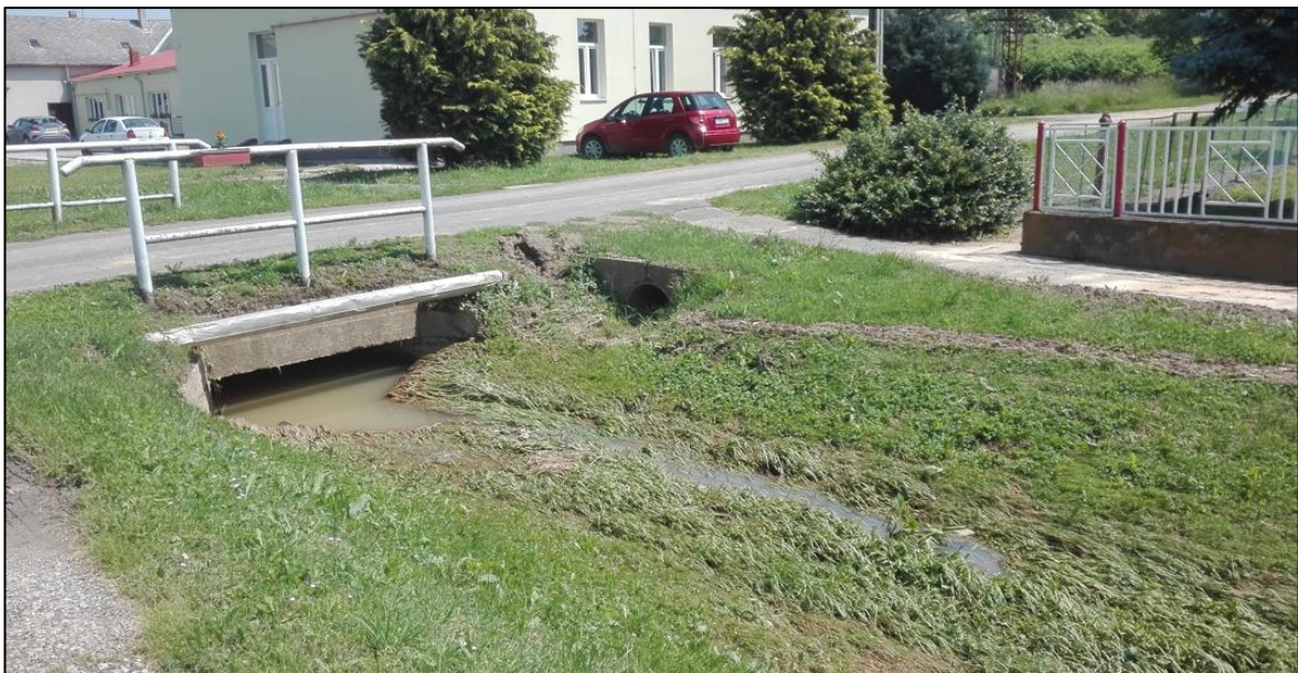
9. ábra. 2021.06.06. Eszteregnye, feliszapolódott híd és áttereszt (Forrás: NYUDUVIZIG)
