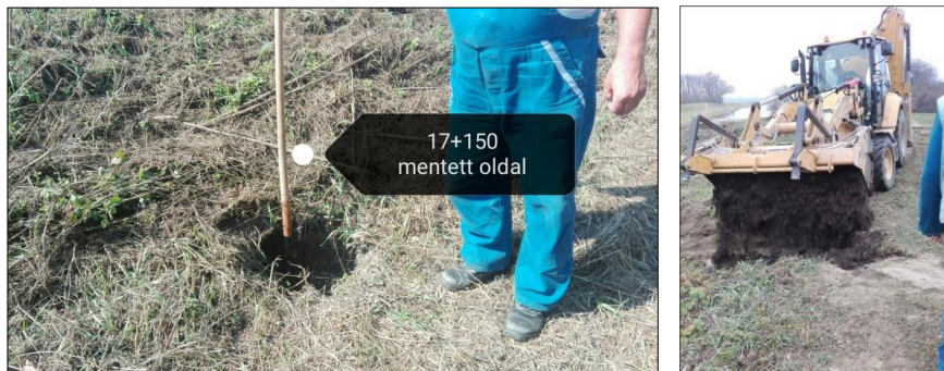
6. ábra: Hód által árvízvédelmi földműben okozott kár és az árvízi biztonság helyreállítása Forrás: ÉDUVIZIG 2016.
