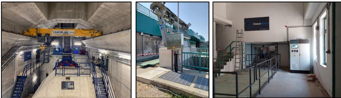
11.,12.,13. kép: Az elkészült vízerőtelep
