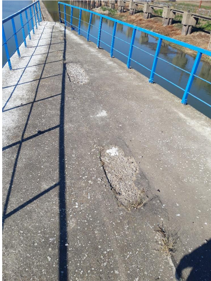
11. ábra Hajózsilip járófelülete a felújítás előtt
