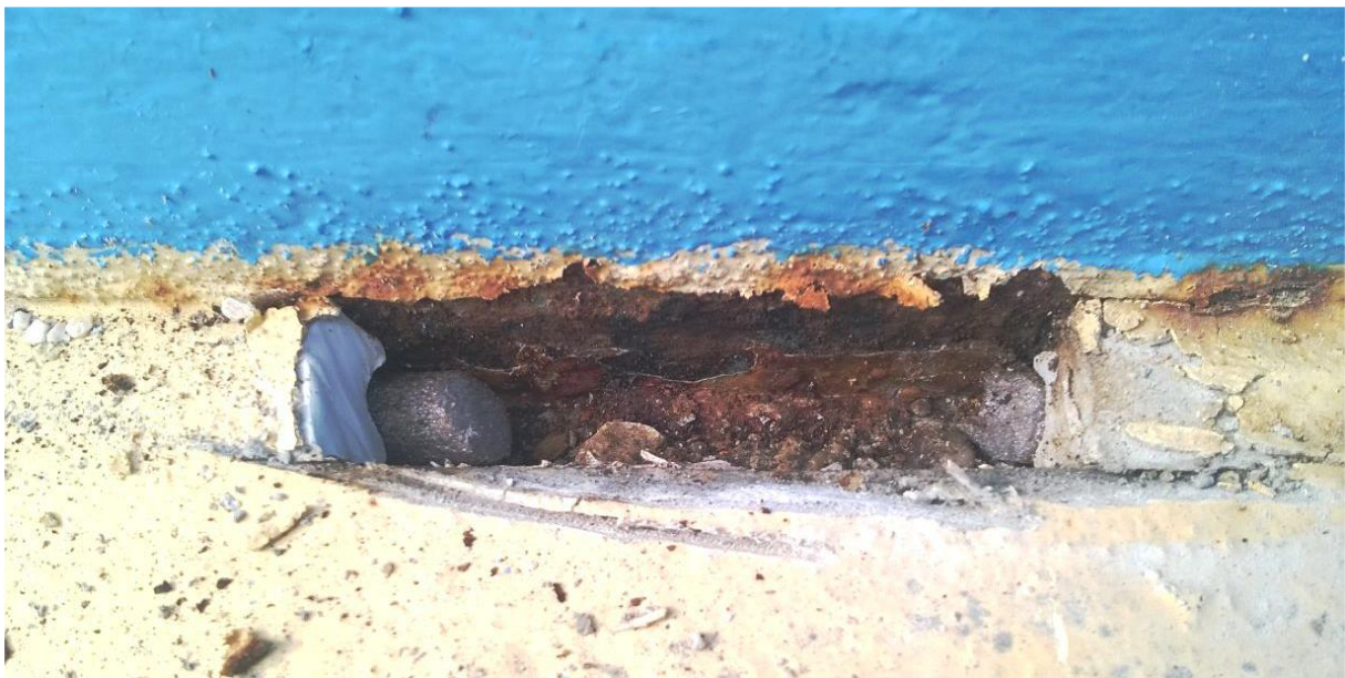
15. ábra Korrózió az acél mellvédfal és a beton pályalemez járófelületének csatlakozásánál
