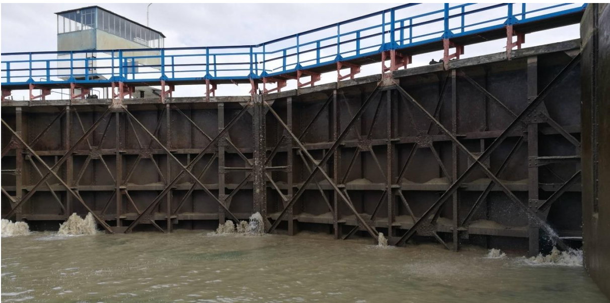
19. ábra Korrodált, tömítetlen hajózsilip kapu
