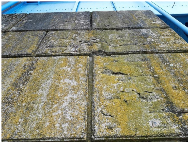
6. ábra Károsodott pillérburkolat
