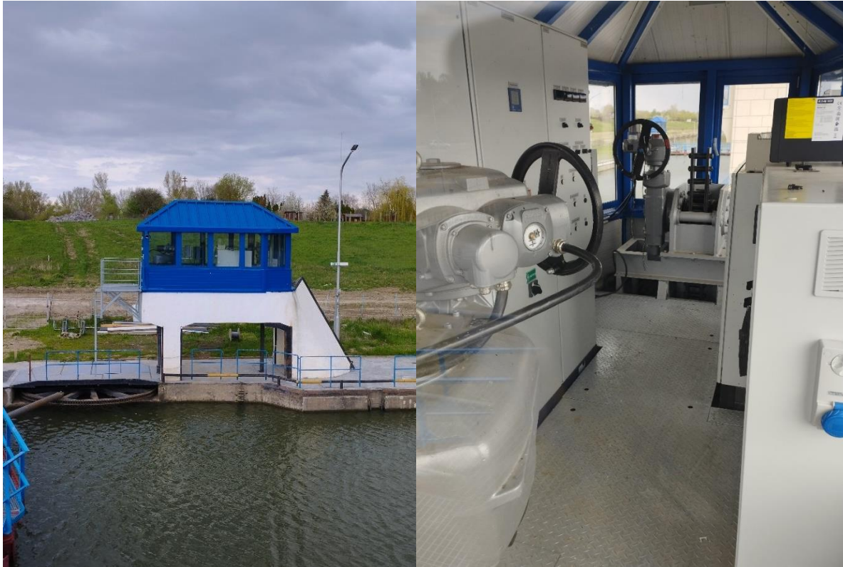
26. ábra A felújított hajószilip gépház (b) és gépészete (j)
