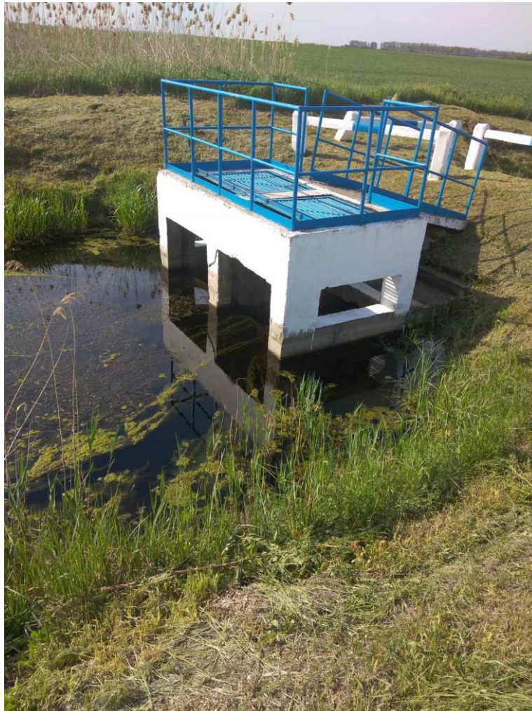
4. ábra Hamvas-főcsatorna 15+673 km szelvényében lévő betétpallós duzzasztó (Készítette: Kiss Ádám, csatornaőr, 2023.05.03.)
