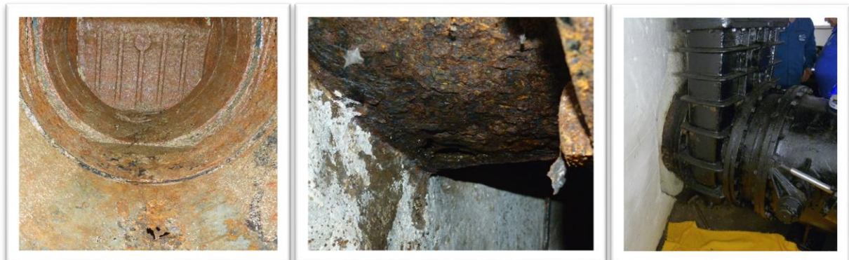
7. sz. képsorozat: Körtvélyesi szivattyútelep – 2019. évi nyomócső meghibásodás
