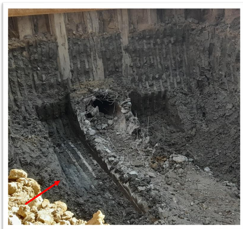
14. sz. kép: Vízoldali nyomócső bontás, oldalsó beton talpazat (nyilvántartástól eltérő)
