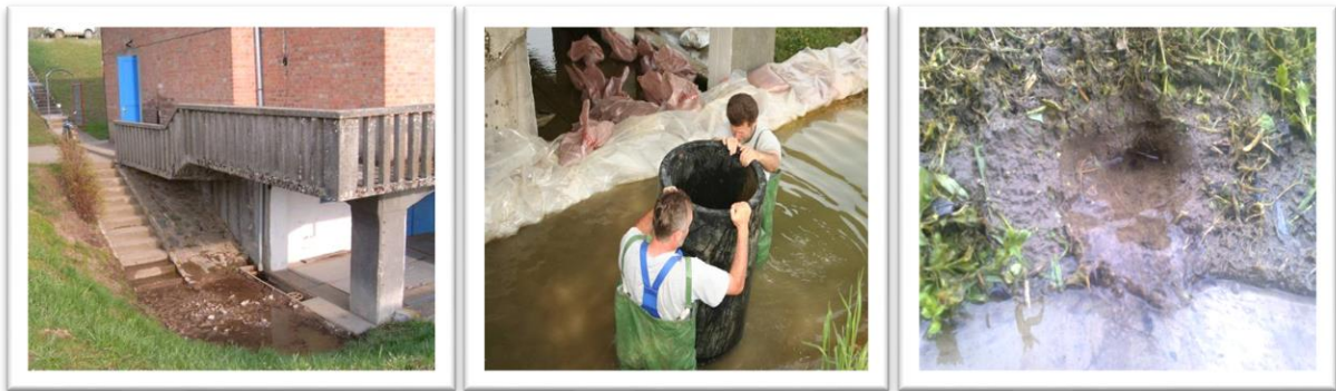
10. sz. képsorozat: Körtvélyesi szivattyútelep – Buzgárosodás
